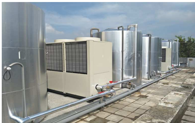
四肯學舍 A、B 區熱泵系統設備更新
